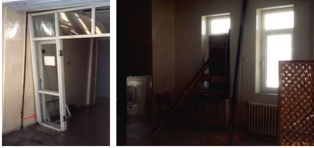
Şekil 7: Pencere ve iç bölme kapısında oluşana hasarlar (25.11.2001)
