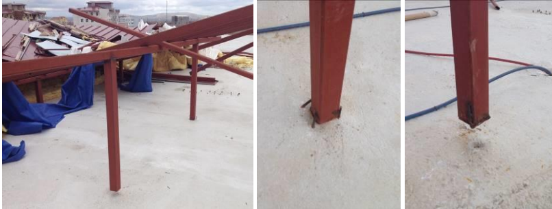
Şekil 15: Betonarme döşeme ile bağlantısı uygun şekilde yapılmayan dikmeler
