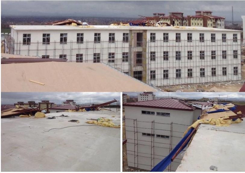
Şekil 14: Rüzgârdan dolayı yıkılan çatı sistemi (28.03.2015)
