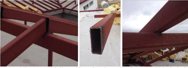
Şekil 16: Mertek ile aşıkların hatalı yapılan kaynaklı birleşimleri (28.03.2015)
