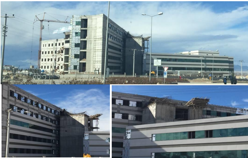
Şekil 18: Rüzgârdan dolayı yıkılan perde duvar kalıpları (18.01.2016)
