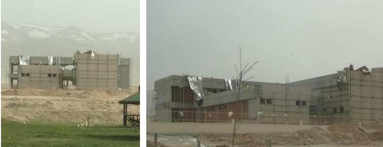
Şekil 11: Çatı ve cephe kaplamalarında meydana gelen hasarlar (18/04/2012)
