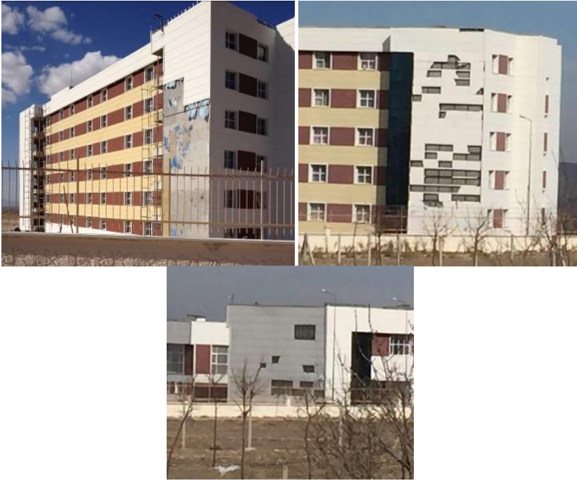
Şekil 12: Yurt binalarının cephe kaplamalarında meydana gelen hasarlar
