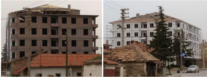
Şekil 13: Yapımı esnasında hasar gören çatı sistemi (18.04.2012)
