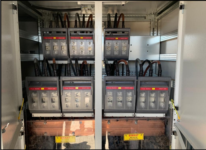
Şekil 14: Ana dağıtım panosu
