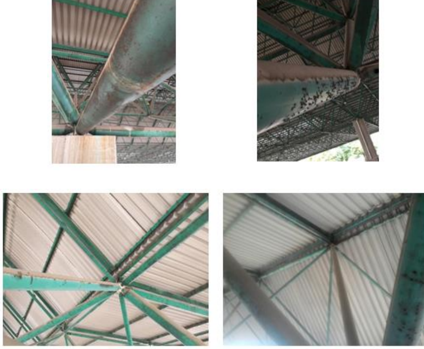
Şekil 9. Taşıyıcı boru kesitli elemanlarda oluşan korozyon/paslanma
