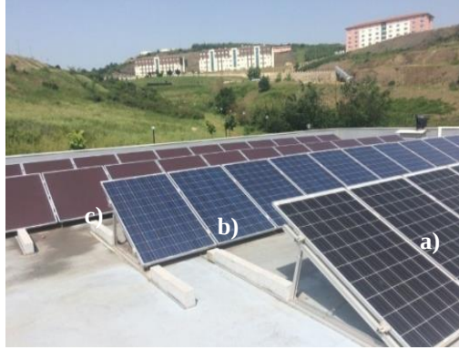
Şekil 3: DÜBİT'in çatısında kurulu bulunan ve toplam 7,5 kW kurulu güce sahip olan (a) m-Si, (b) p-Si ve (c) a-Si fotovoltaiik paneller.
