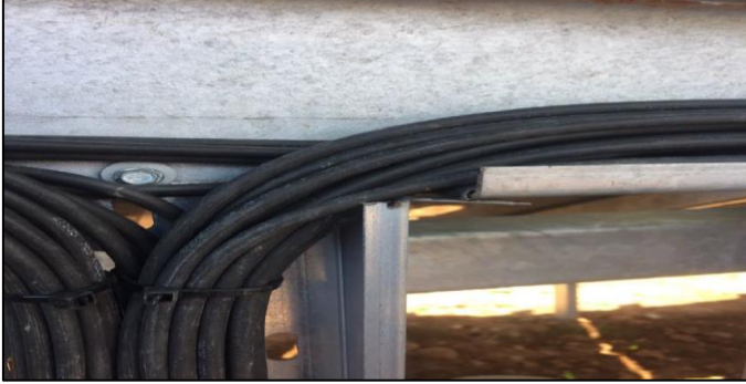
Şekil 12. DC kablolama Hataları-1
