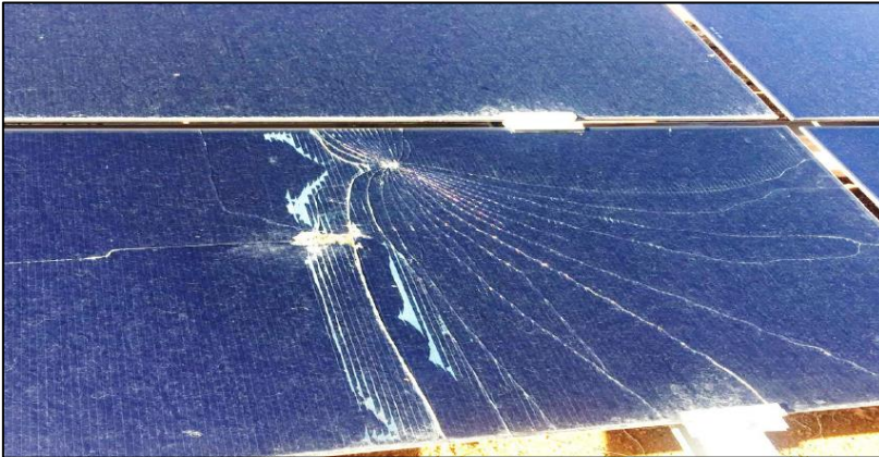
Şekil 9. Kırık fotovoltaik paneller-7
