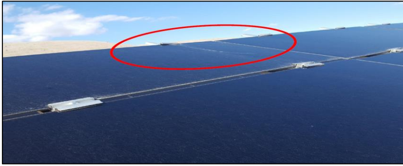
Şekil 5. Kırık fotovoltaik paneller-3
