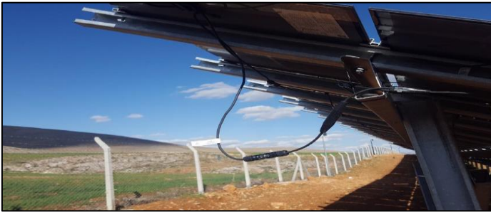
Şekil 14. DC kablolama Hataları-3
