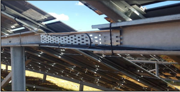
Şekil 13. DC kablolama Hataları-2
